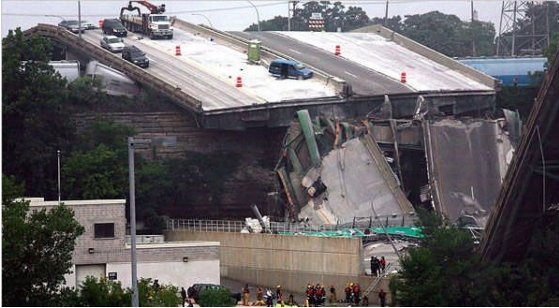
Pont sur la rivière Mississippi s'effondrer le 2 Août 2007.
